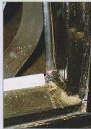
B-scheiden: Meist ist nur der Fuß der mittleren Säule rostgeschädigt
